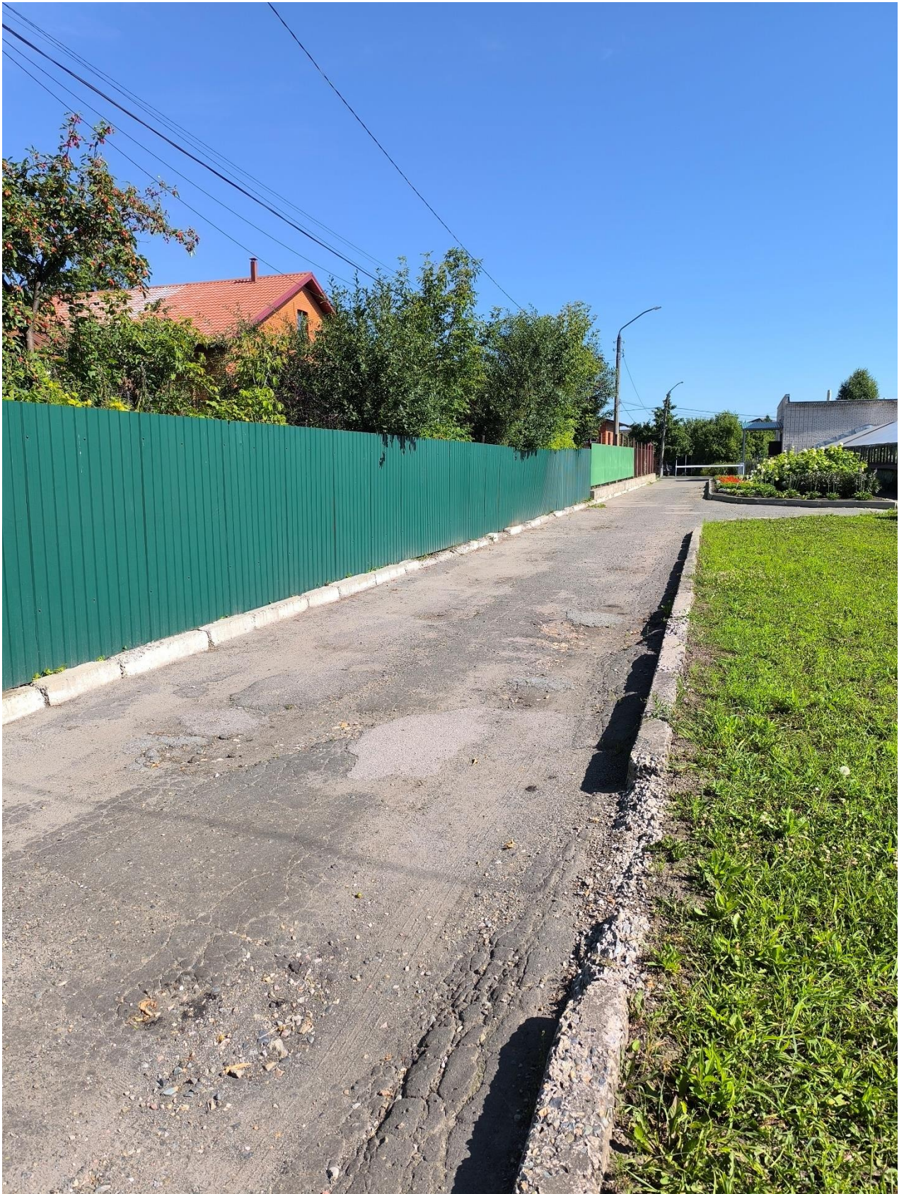
Фото 5 - асфальтовое покрытие требующее замены
